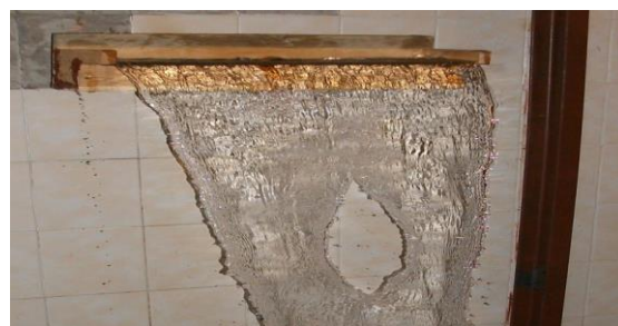
Рисунок 3 – Загальний вигляд суцільного спадаючого вертикального потоку води з утвореними дефектами
