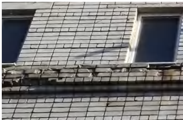
Рис. 3. Разрушение кирпичной кладки / The destruction of masonry
