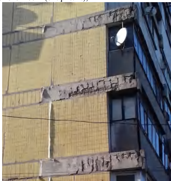
Рис. 2. Разрушение защитного слоя / The destruction of the protective layer
