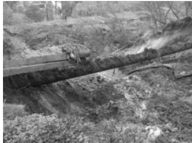
Рис. 2. Газопровід середнього тиску
