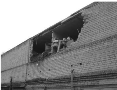
Рис. 3. Зруйнована цегляна кладка
