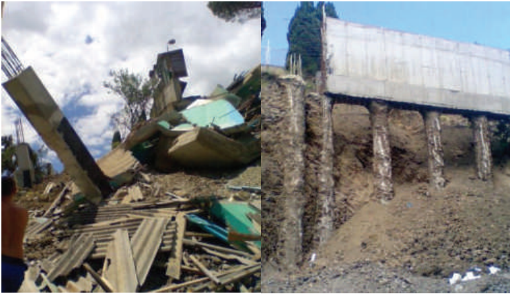
Рис. 1. Разрушение свайной удерживающей конструкции в г.Алушта в 2011 г.
