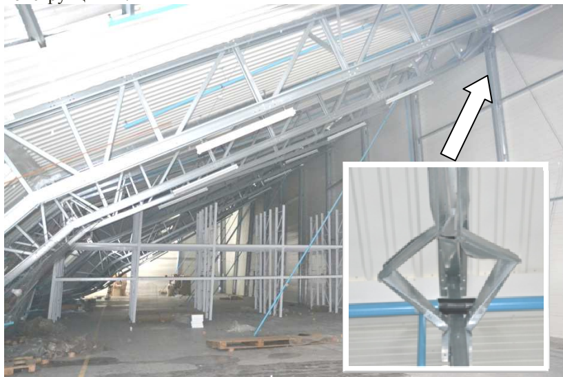
Рисунок 2. Фото обрушенного каркаса
