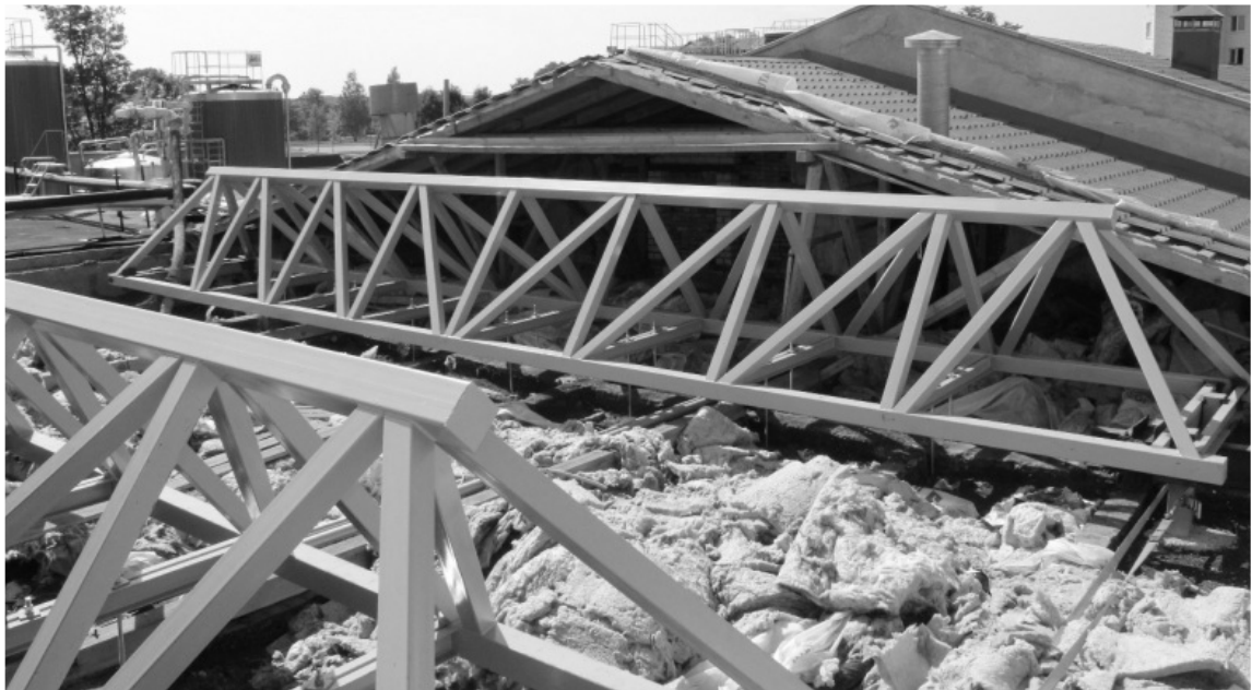
Рис. 3. Конструктивное решение (а) и общий вид трёхгранных ферм из гнутосварных профилей (б)
