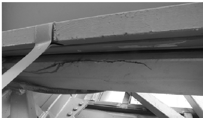
Рис. 1. Ошибки при конструировании ферм из ГСП: а – несоответствие угла наклона стержней решетки в узлах требованиям [2, 3]; б – трещины в поясах ферм из-за некачественных сварных швов
