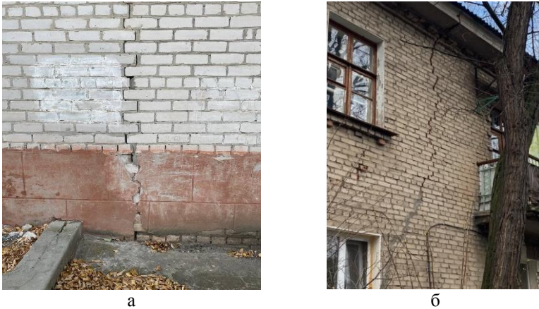
Рис. 3. Значна наскрізна вертикальна тріщина розкриттям 1...2 см, що йде вгору від цоколя (а) на всю висоту стіни з розшаруванням кладки (б)
