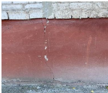
Рис. 2. Розвинена вертикальна тріщина розкриттям до 0,5 см
