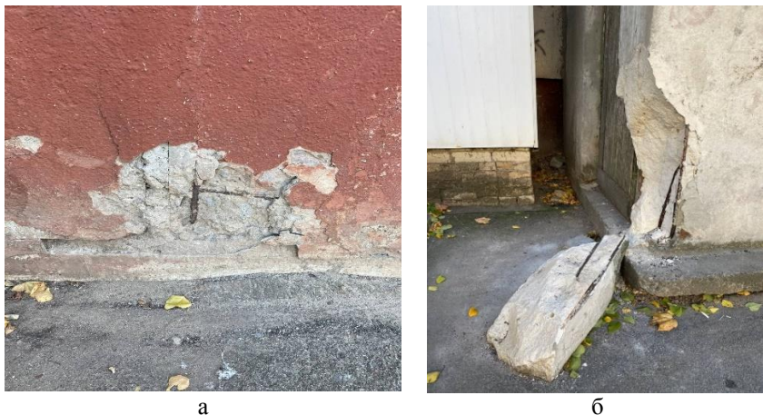
Рис. 5. Корозія арматури: відшарування верхнього шару бетону (а); кутове сколювання бетонної стіни (б)
