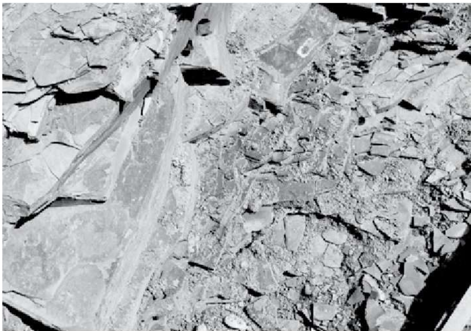
Рис. 1. Карпатський фліш в котловані(тріщинувато-блочна будова).
