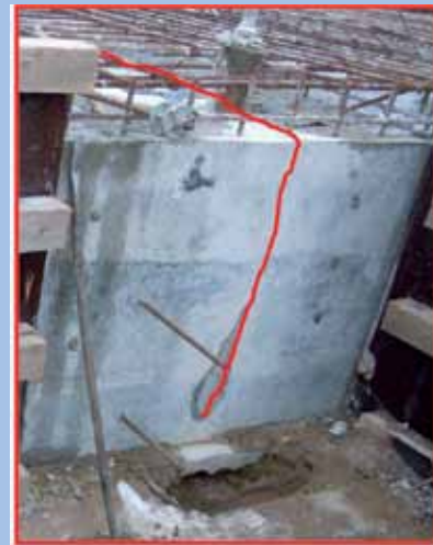
Рис. 10. Вод фундамента с отображением трещины
