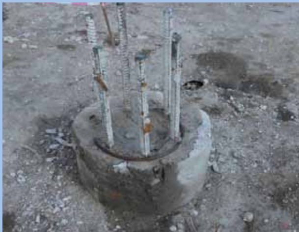
Рис. 8. Фильтрация воды через тело сваи (эффект «плачущих» свай)
