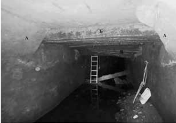
Рис 3. Коллектор ливневой канализации: А- боковые укосы от стенок к кровле; Б- крепление кровли горизонтальными железобетонными балками; В- участок деформации и обрушения кровли.
