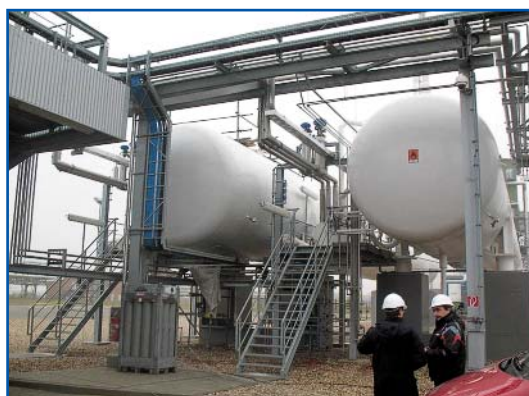
Фото 4. Водородные резервуары 2×250 м 3 на заводе «Linde AG» в Лейне (Германия)
