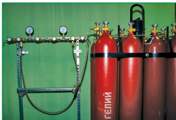
Фото 1. Подключение моноблока к разрядной рампе
