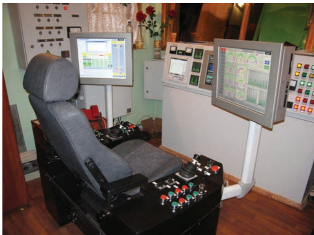
Рис. 2. Пульт управления шахтной подъемной машиной ПУШПМ.
