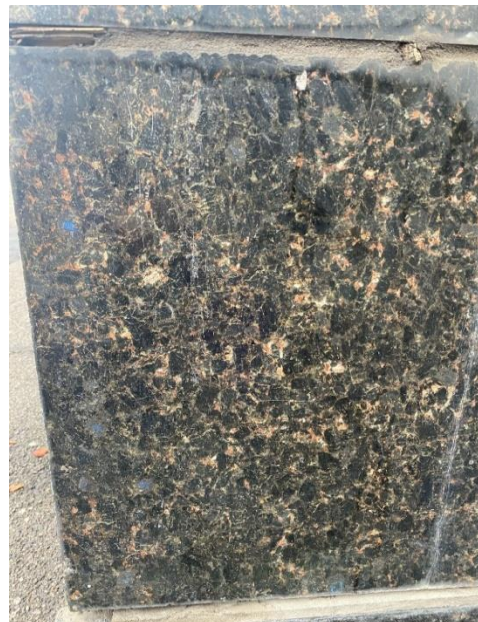
Рис. 7. Дефекти облицювання лабрадоритом зовнішньої частини актового залу академії
