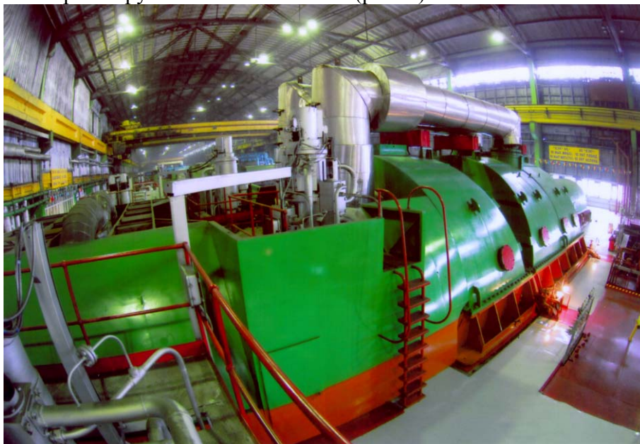
Рис. 2. Паровая турбина К-325-23,5 в машинном зале ТЭС «Аксу», Казахстан
