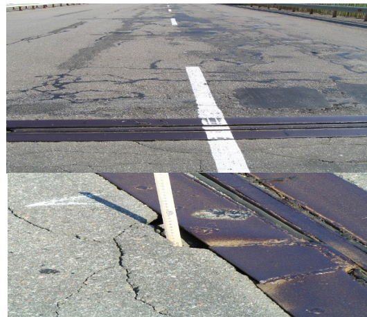
Рис. 2. Руйнування шарів дорожнього одягу вздовж деформаційного шва шляхопроводу на автомобільній дорозі М 29 Харків-Красноград-Перещепіно (Люботин-Мерефа) в селищі Люботин
